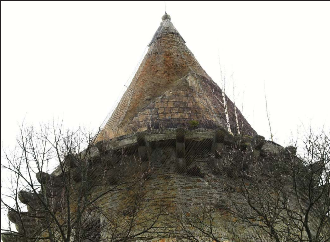
Provizorní zajištění vrcholu věže sítě proti odpadávání zvětralých kusů zdivné helmic, 2012, archiv NPU Temporary securing of the top of the tower with netting against the falling out of weathered pieces of the masonry roof, 2012, NHI archive
